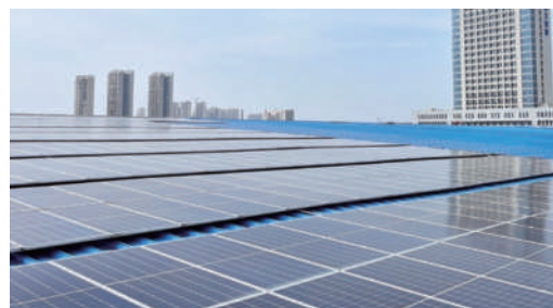
工場に設置した太陽光発電設備
