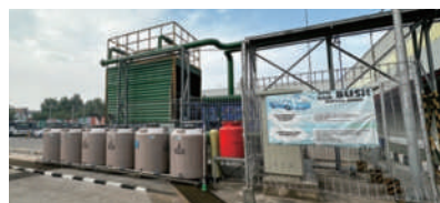
クーリングタワーと貯水タンク
